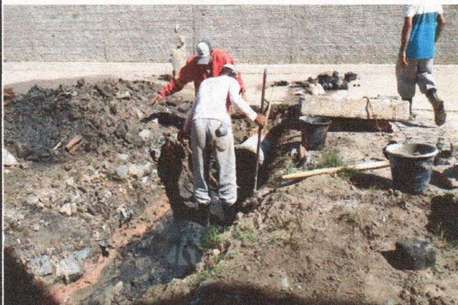
FOTO 09 ( RUA ITAMARACÁ - BAIRRO NOVA ESPERANÇA )
