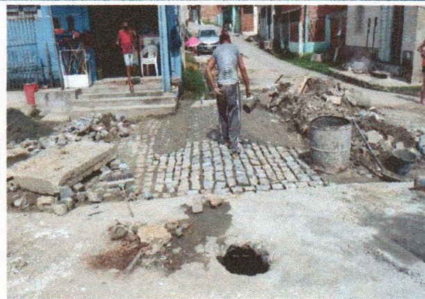
FOTO 12 ( RUA ITAMARACÁ - BAIRRO NOVA ESPERANÇA )
