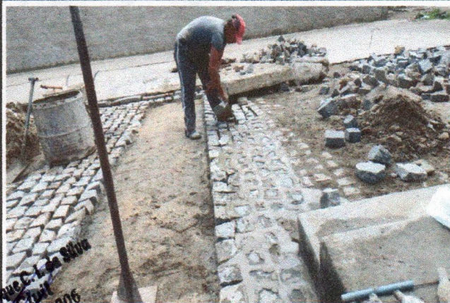
FOTO 11 ( RUA ITAMARACÁ - BAIRRO NOVA ESPERANÇA )
