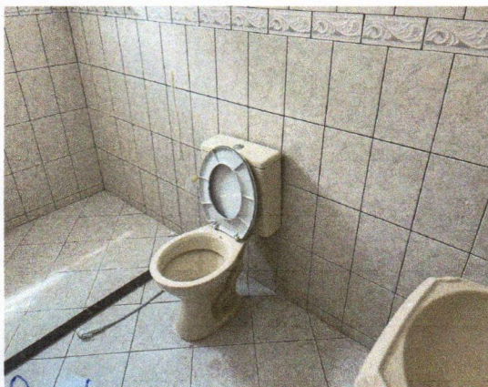
BAIXA SANITÁRIO COM CAIXA ACOPLADA
