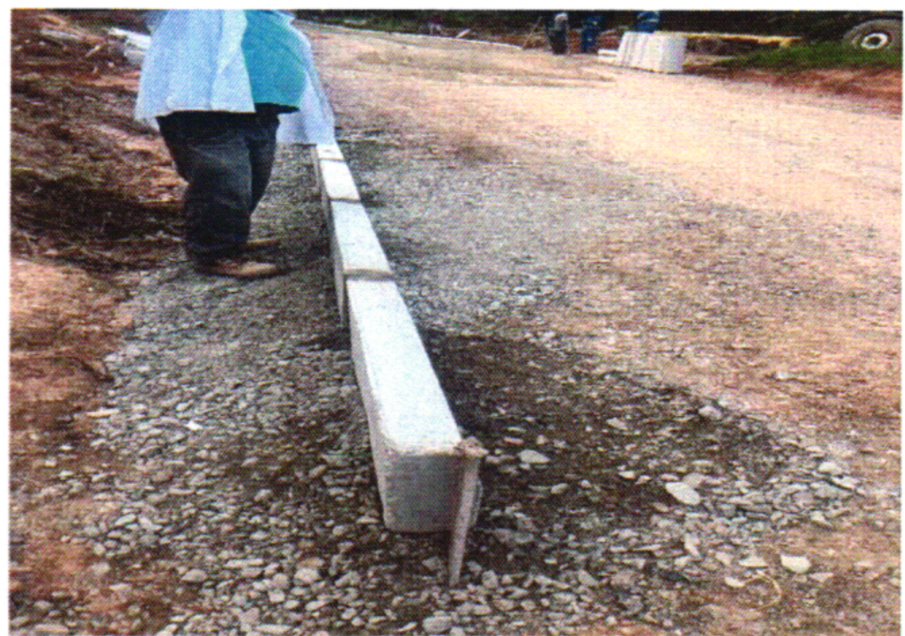
ASENTAMENTO MEIO FIO
