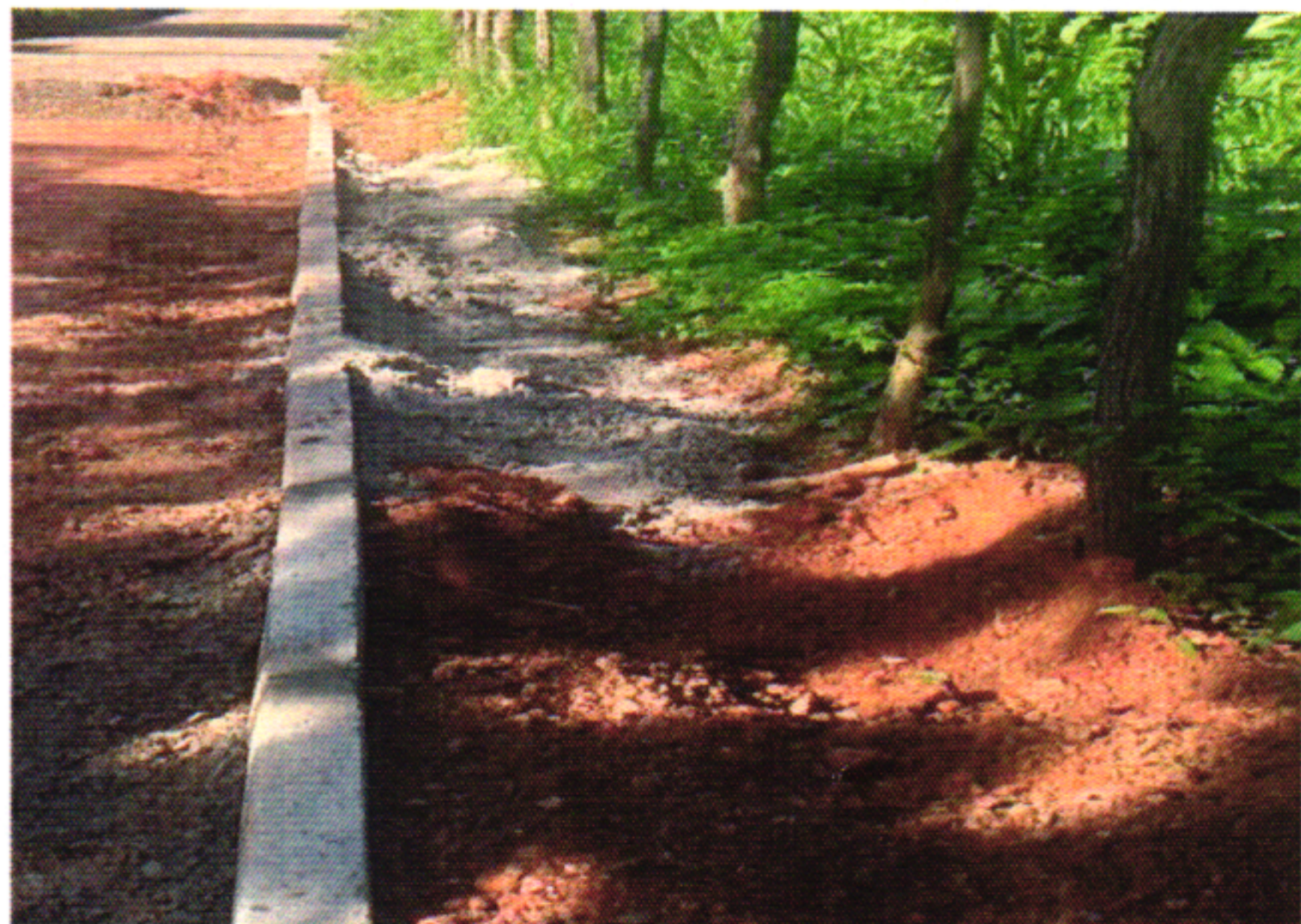
ASENTAMENTO MEIO FIO
