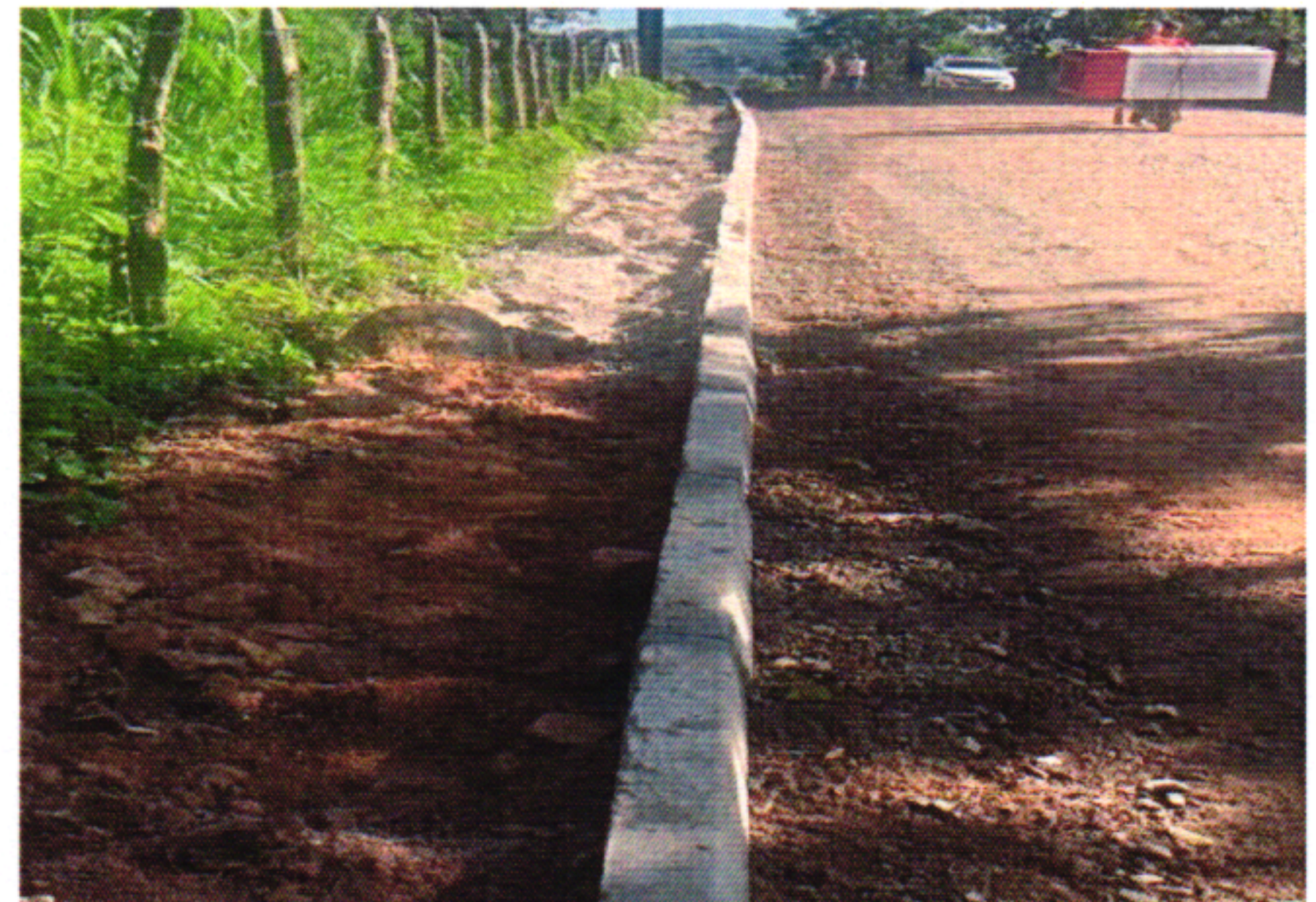
ASENTAMENTO MEIO FIO
