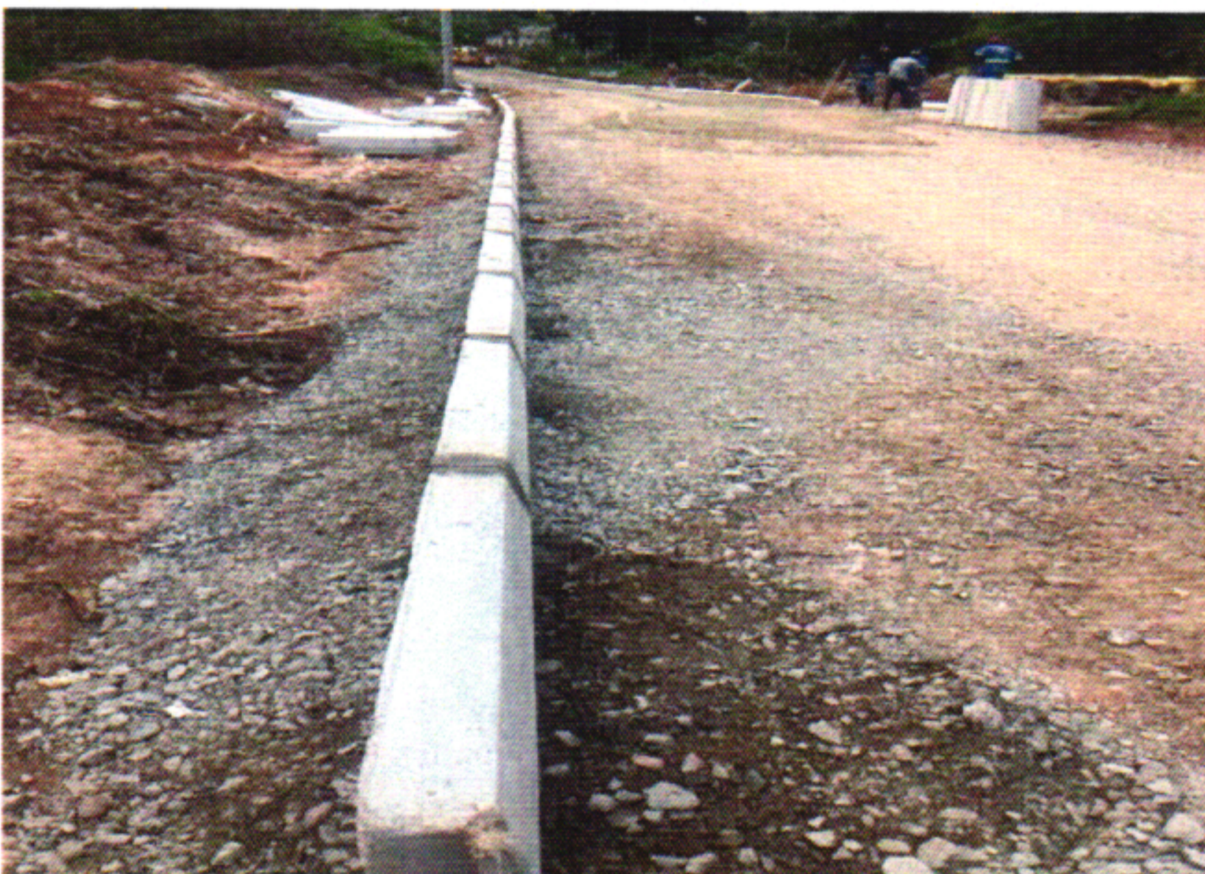
ASENTAMENTO MEIO FIO
