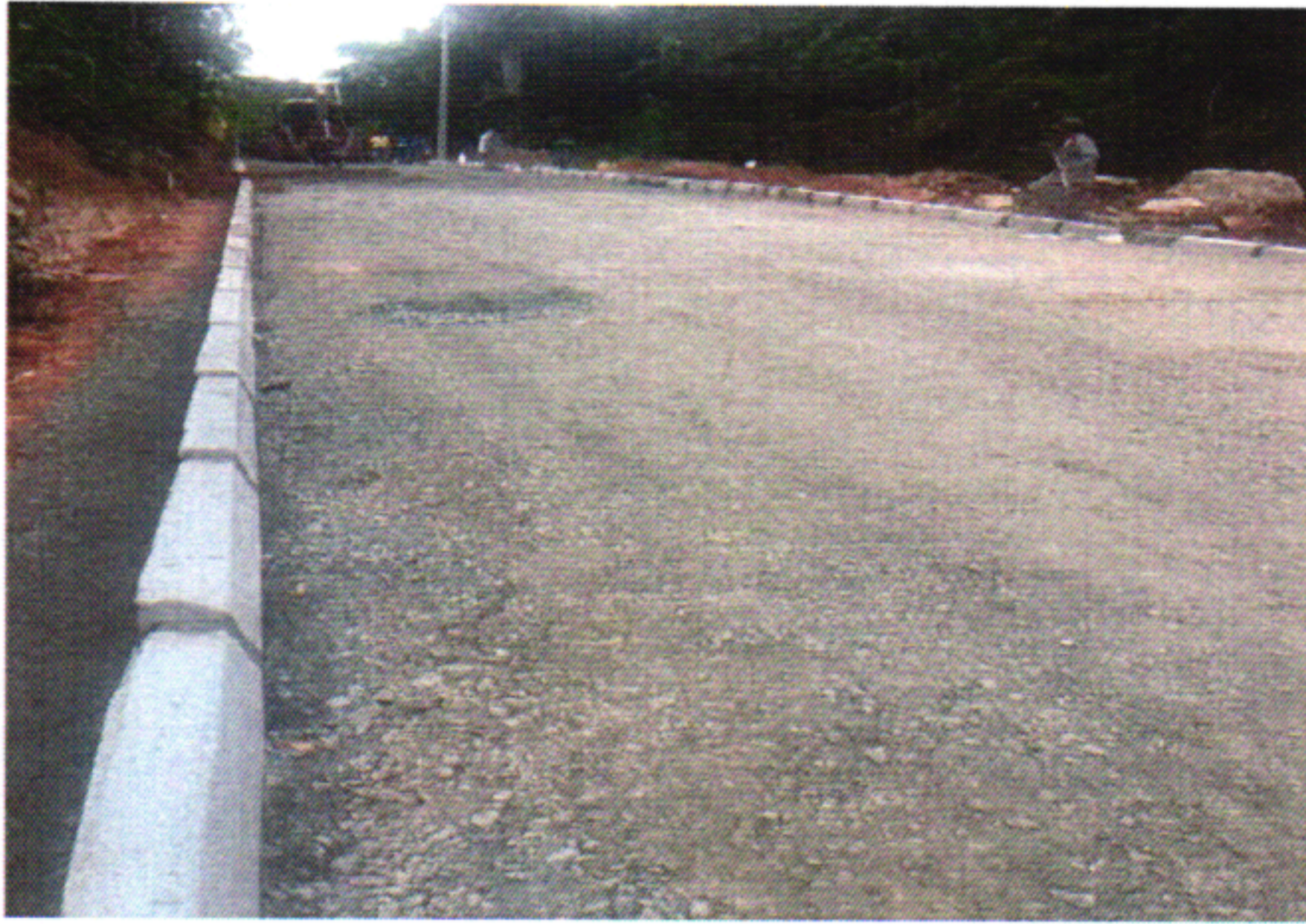
ASENTAMENTO MEIO FIO
