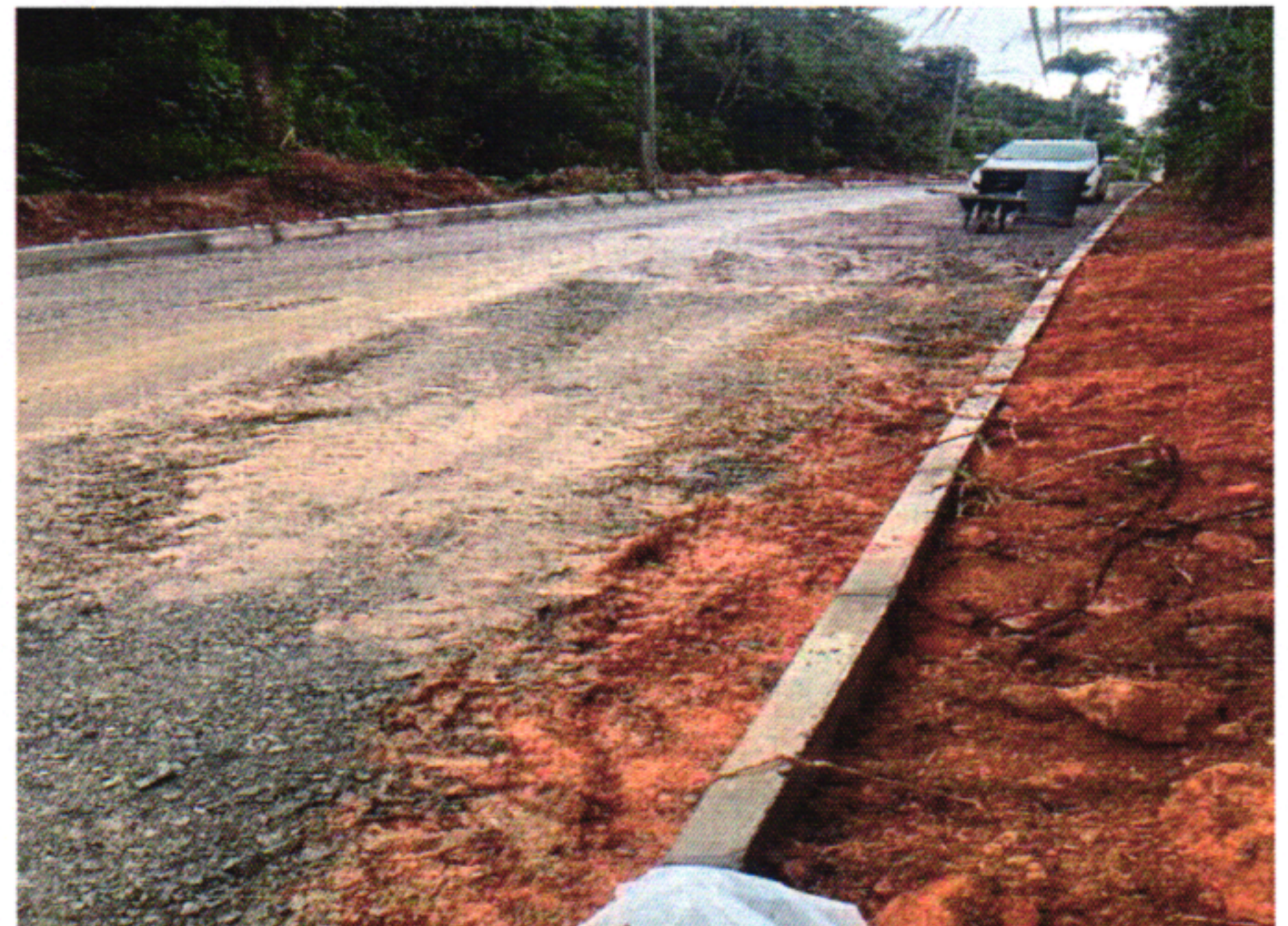
ASENTAMENTO MEIO FIO SCAVE Serviços de Engª e Locação
