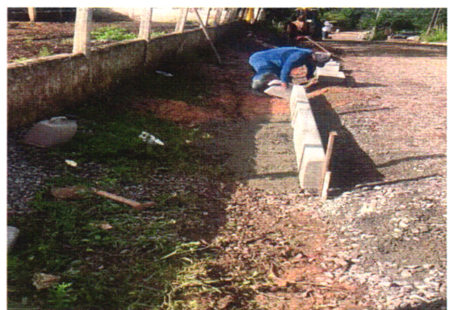
ASENTAMENTO MEIO FIO
