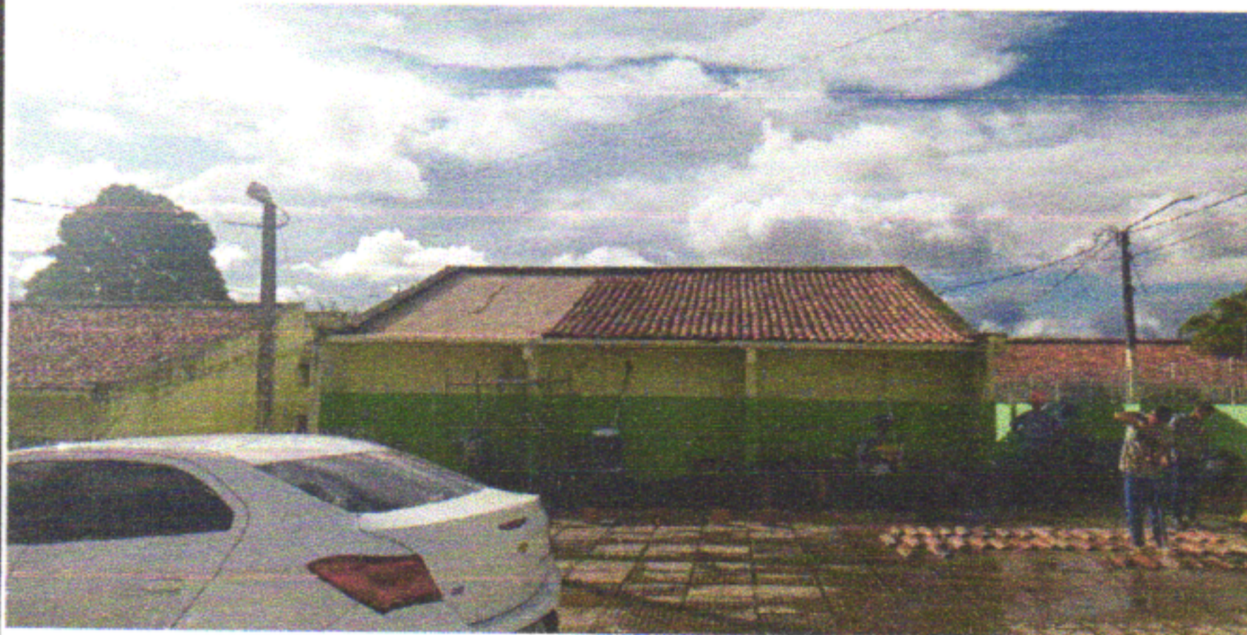
TELHAMENTO E RETELHAMENTO COM TELHA CANAL COM UTILIZAÇÃO DE ANDAIME E LAVAGEM DAS TELHAS ANTIGAS
