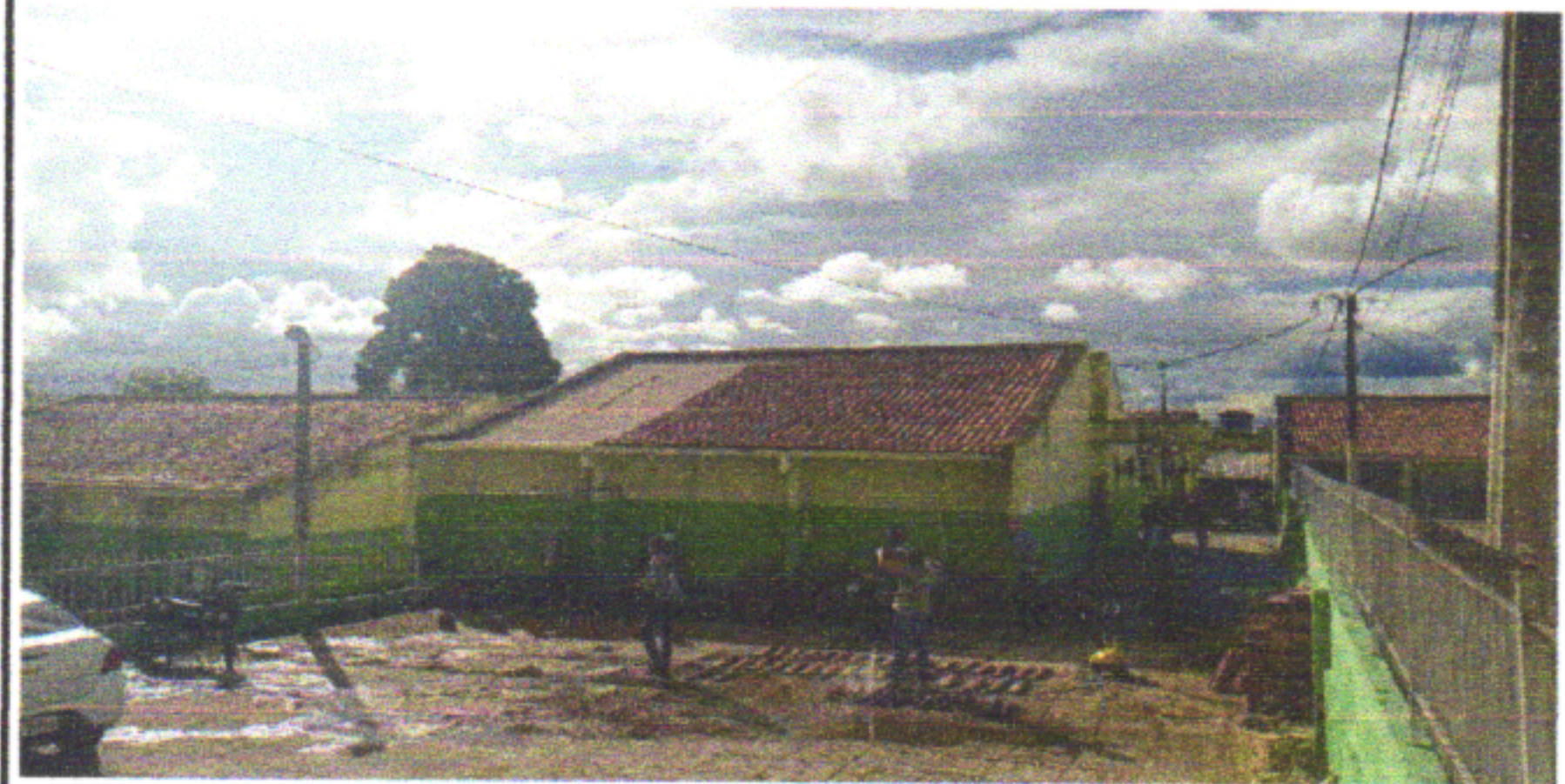
TELHAMENTO E RETELHAMENTO COM TELHA CANAL COM UTILIZAÇÃO DE ANDAIME E LAVAGEM DAS TELHAS ANTIGAS
