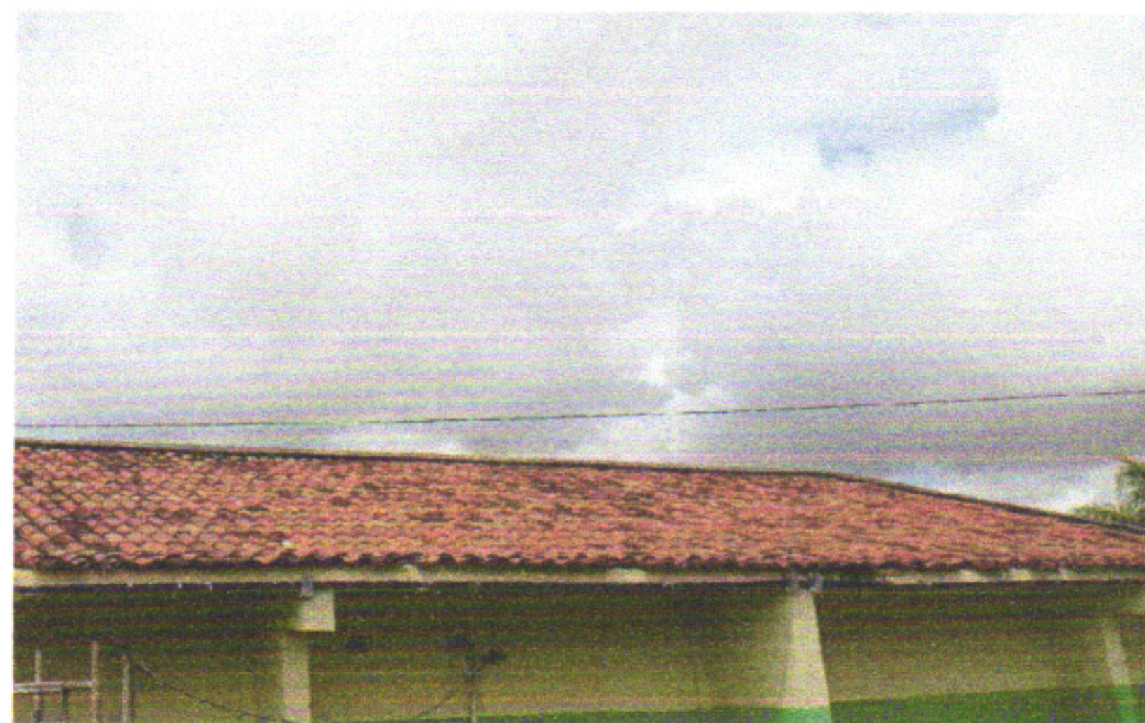
ANTES DO RETELHAMENTO
