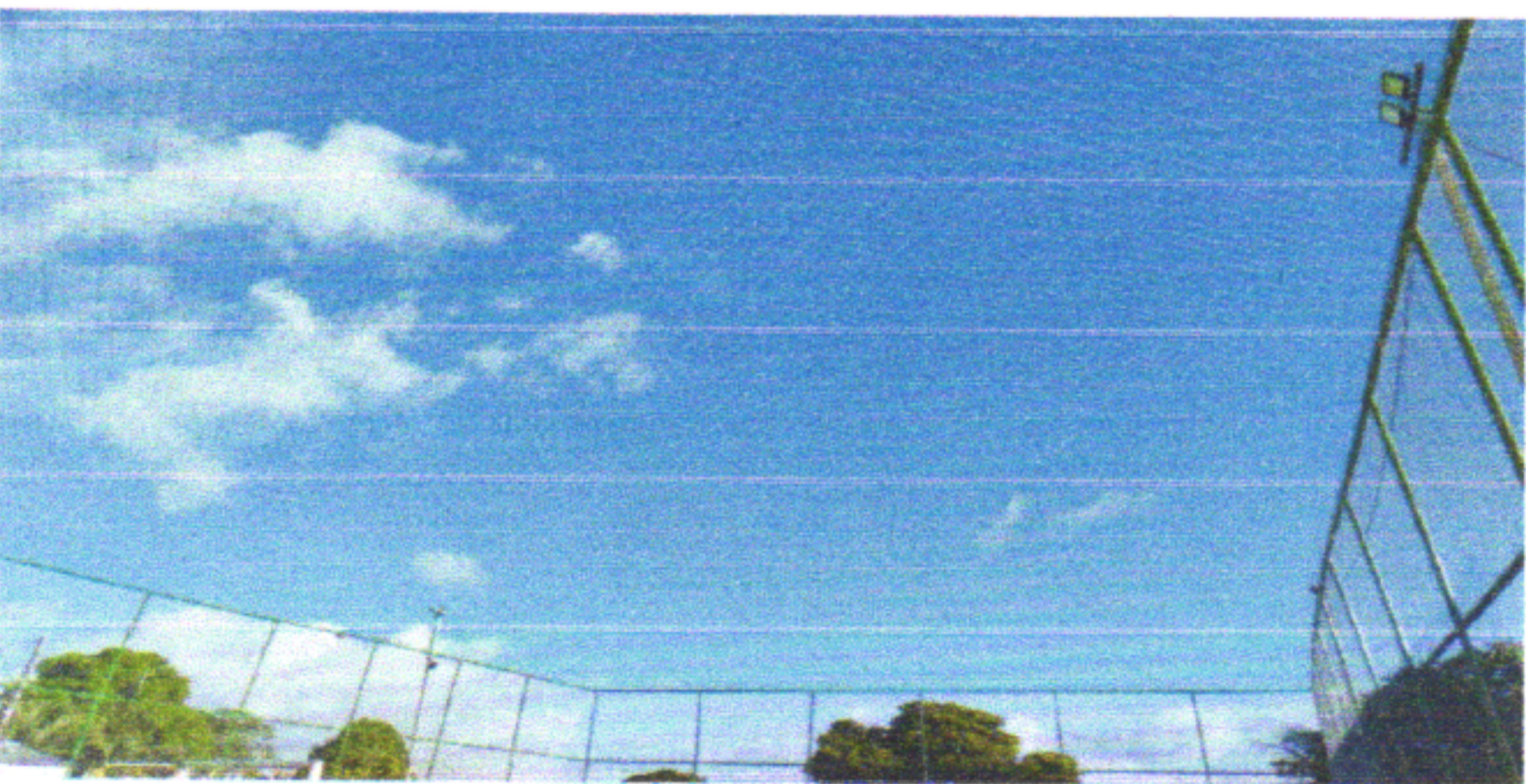
COLOCAÇÃO DA TELA EM NYLON E FIXAÇÃO COM CABOS DE AÇO NA PARTE SUPERIOR NA QUADRA
