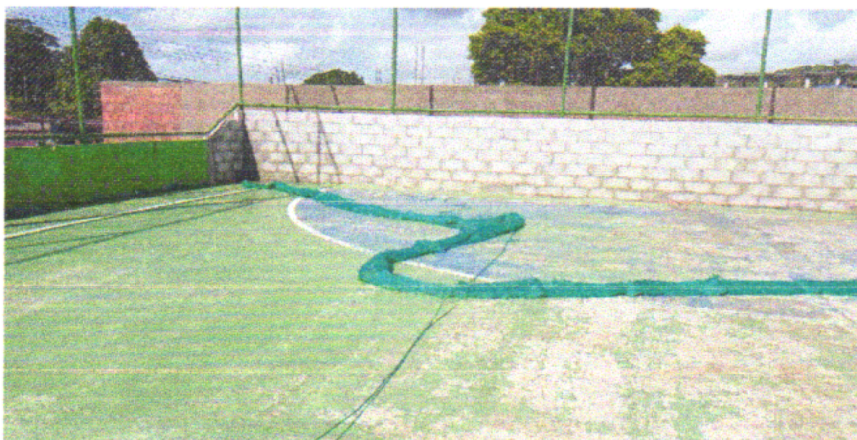
COLOCAÇÃO DA TELA EM NYLON E FIXAÇÃO COM CABOS DE AÇO NA PARTE SUPERIOR NA QUADRA
