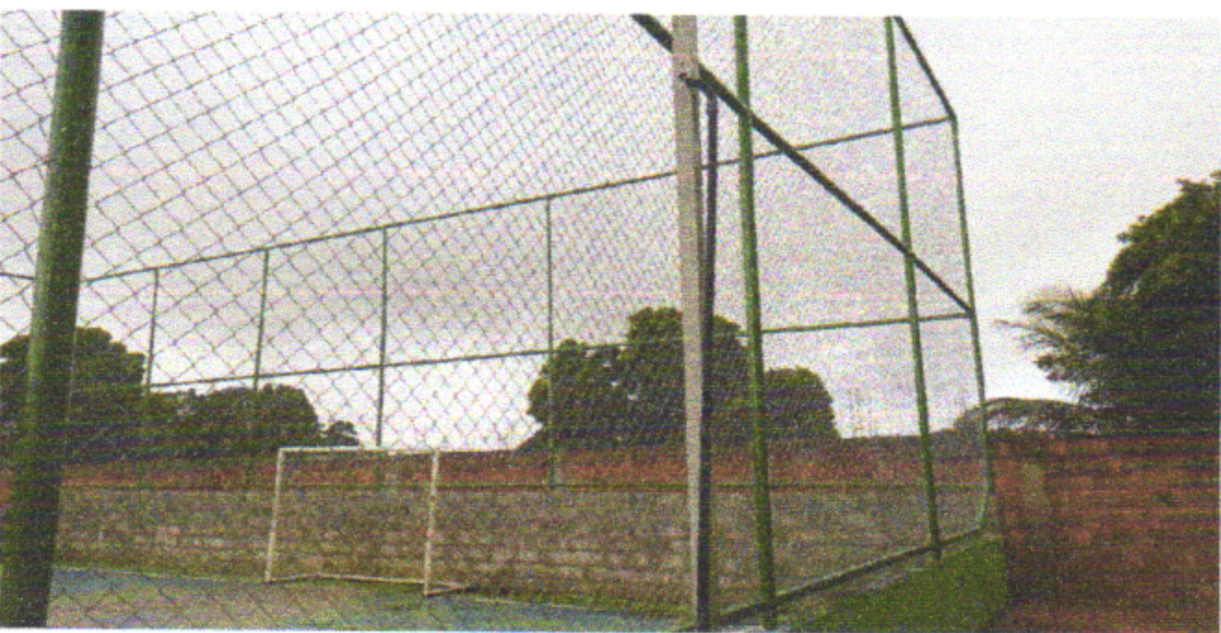
PINTURA ESMALTE DO ALAMBRADO E COLOCAÇÃO DAS TELAS GALVANIZADA NAS LATERAIS DA QUADRA
