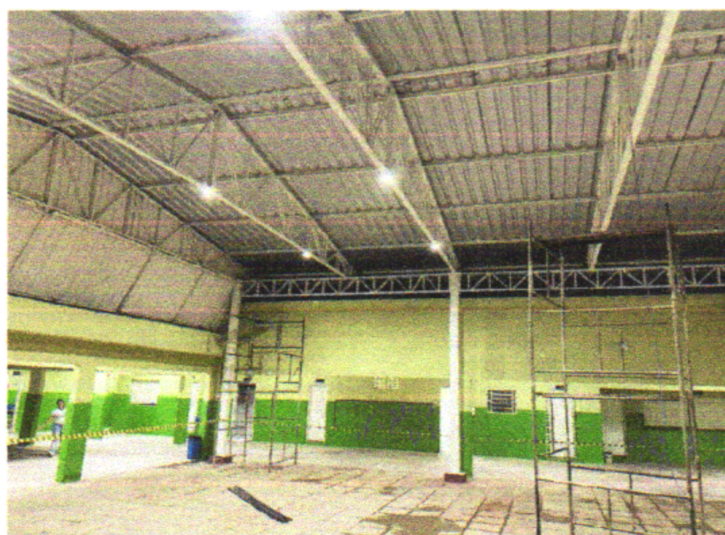
PONTOS DE ILUMINAÇÃO E REFLETORES NA COBERTA METÁLICA
