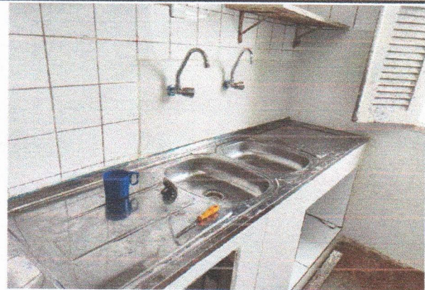
ESCOLA MUNICIPAL PADRE JOÃO COLLIGNON - TORNEIRA DE PAREDE, VÁLVULA, SIFÃO DUPLO E REVESTIMENTO CERÂMICO - COZINHA
