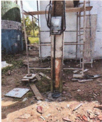
ESCOLA MUNICIPAL SENADOR FRANCISCO GOMES DE ARAÚJO - ELETRODUTO 3/4"
