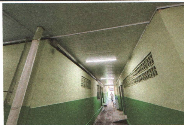
ESCOLA MUNICIPAL PADRE JOÃO BARBALHO - INSTALAÇÃO DO FORRO PVC, INSTALAÇÃO DE PONTOS ELÉTRICOS E SEUS CIRCUITOS
