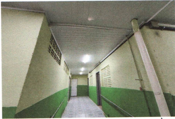
ESCOLA MUNICIPAL PADRE JOÃO BARBALHO - INSTALAÇÃO DO FORRO PVC, INSTALAÇÃO DE PONTOS ELÉTRICOS E SEUS CIRCUITOS
