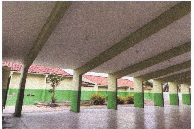
ESCOLA MUNICIPAL APOLÔNIO SALES - APLICAÇÃO DE PINTURA ACRÍLICA NAS PAREDES E TETO
