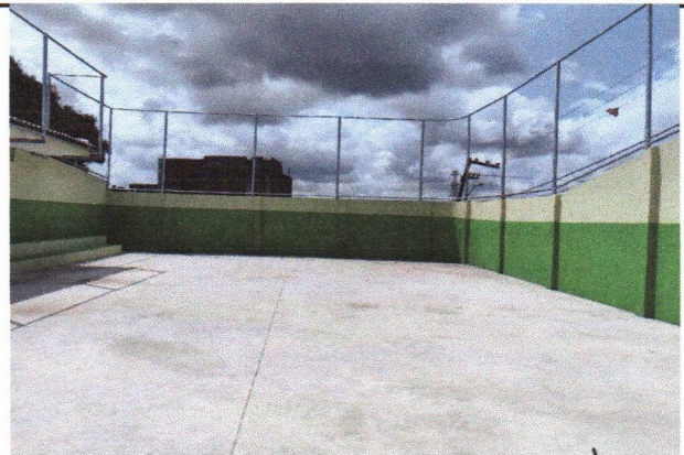
ESCOLA MUNICIPAL INÁCIO GOMES DA SILVA - APLICAÇÃO DE PINTURA ACRÍLICA NAS PAREDES
