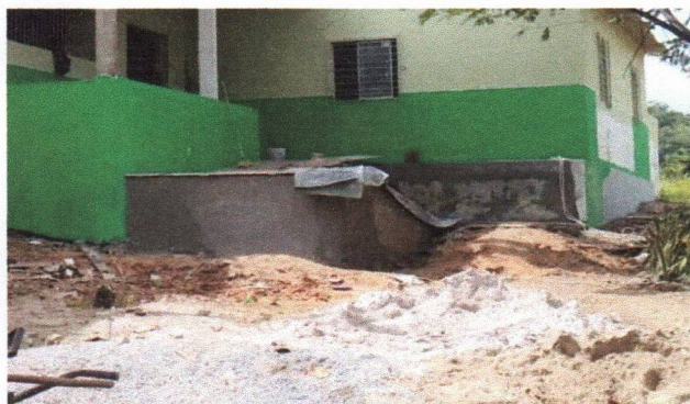
ESCOLA MUNICIPAL SENADOR FRANCISCO GOMES DE ARAÚJO - REBOCO
