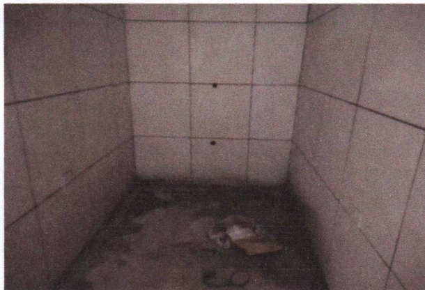
ESCOLA MUNICIPAL SENADOR FRANCISCO GOMES DE ARAÚJO - PONTO ELÉTRICO DE TOMADA E PONTO DE ÁGUA E ESGOTO
