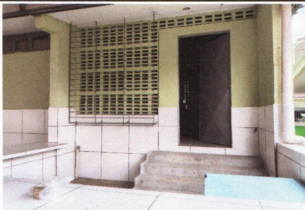
ESCOLA MUNICIPAL APOLÔNIO SALES - PORTA EM CHAPA COM APLICAÇÃO DE ZARCÃO E PINTURA ESMALTE SINTÉTICO
