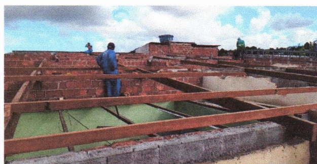
ESCOLA MUNICIPAL CLODOALDO GOMES DE ARAÚJO - ELEVAÇÃO DE ALVENARIA DE BLOCO CERÂMICO
