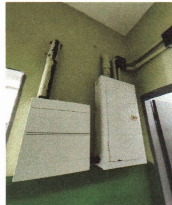
ESCOLA MUNICIPAL INÁCIO GOMES DA SILVA - QUADRO DE DISTRIBUIÇÃO COM DISJUNTORES
