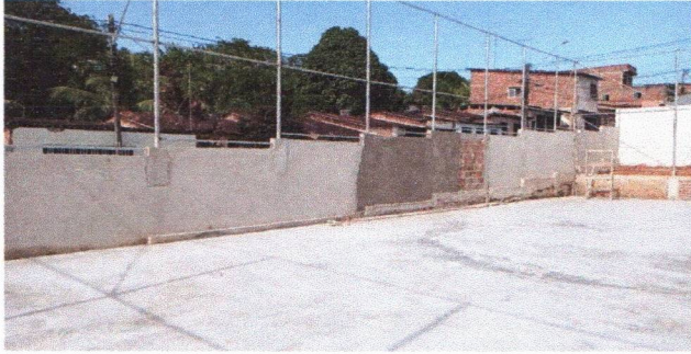
ESCOLA MUNICIPAL ERCINA LAPENDA - REBOCO NA MURETA DA QUADRA
