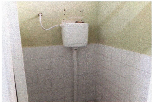
ESCOLA MUNICIPAL PAULO GOMES DE ARAÚJO - INSTALAÇÃO DE DESCARGA SUSPENSA DE SOBREPOR
