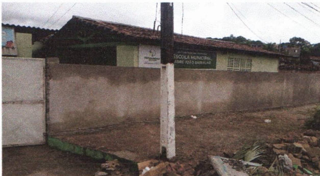
ESCOLA MUNICIPAL PADRE JOÃO BARBALHO - REBOCO NO MURO FRONTAL
