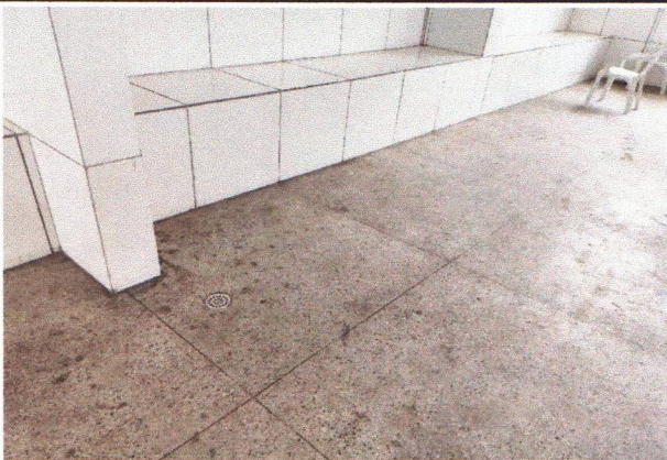
ESCOLA MUNICIPAL APOLÔNIO SALES - PONTO DE ESGOTO (RALO), POLIMENTO E RESINA NO PISO
