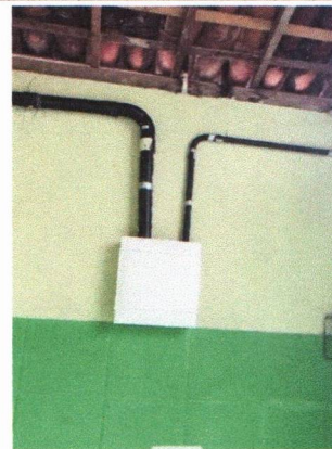
ESCOLA MUNICIPAL PADRE JOÃO BARBALHO - INSTALAÇÃO DO QUADRO DE DISTRIBUIÇÃO COM DISJUNTORES
