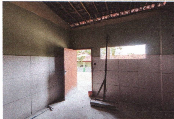
ESCOLA MUNICIPAL FRANCISCO TAVARES - INSTALAÇÃO DE KIT DE PORTAS E ASENTAMENTO DO REVESTIMENTO CERÂMICO (BLOCO A)
