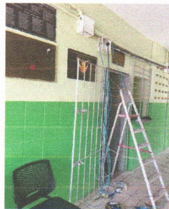
ESCOLA MUNICIPAL INÁCIO GOMES DA SILVA (CABEAMENTO DO SISTEMA DE AR CONDICIONADO)
