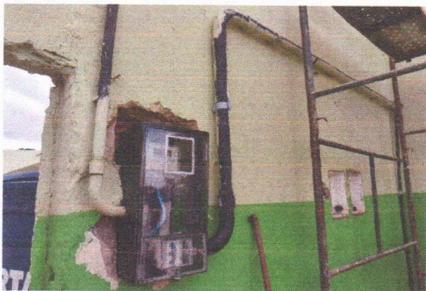
ESCOLA MUNICIPAL INÁCIO GOMES DA SILVA (CABEAMENTO DE ALIMENTAÇÃO)
