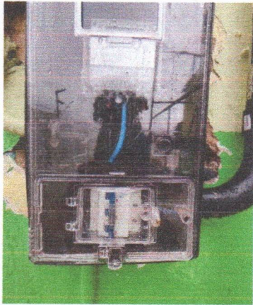
ESCOLA MUNICIPAL INÁCIO GOMES DA SILVA (CABEAMENTO DE ALIMENTAÇÃO)
