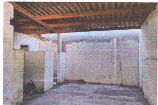
ESCOLA MUNICIPAL INÁCIO GOMES DA SILVA (TELHAMENTO COM TELHA ONDULADA DE FIBROCIMENTO)
