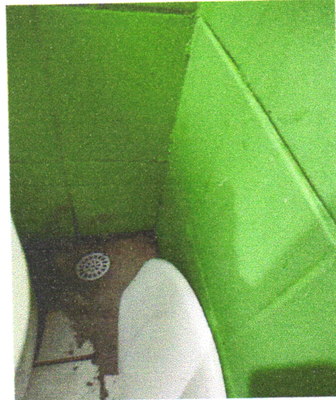
ESCOLA MUNICIPAL JOAQUIM DE BRITO - PONTO DE ESGOTO (RALO)
