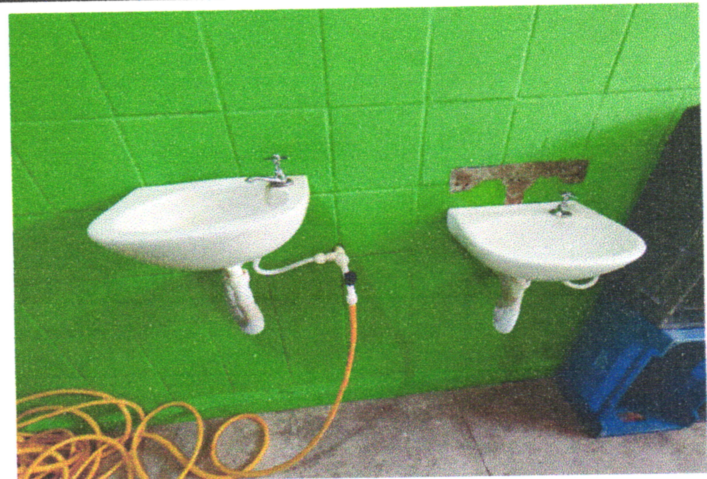
ESCOLA MUNICIPAL JOAQUIM DE BRITO - TORNEIRA, SIFÃO, VÁLVULA, ENGATE
