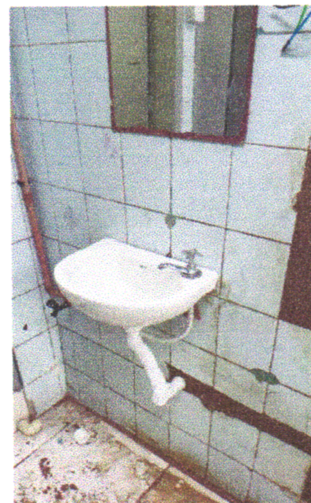
ESCOLA MUNICIPAL CLETO CAMPELO (ANEXO 2) - PONTO DE ÁGUA, TORNEIRA, SIFÃO, VÁLVULA, ENGATE
