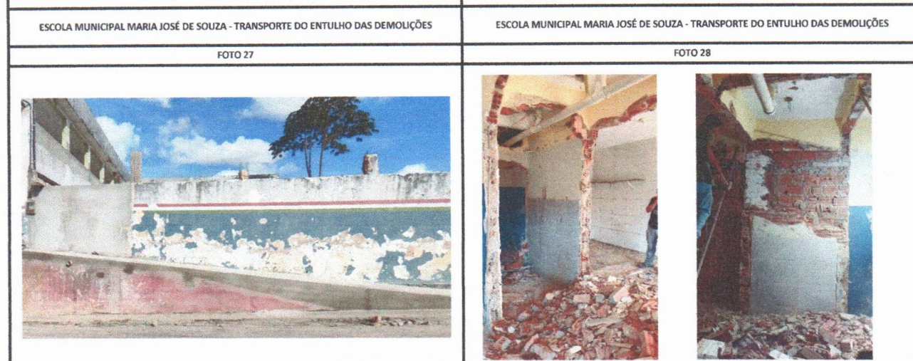
ESCOLA MUNICIPAL MARIA JOSÉ DE SOUZA - TRANSPORTE DO ENTULHO DAS DEMOLIÇÕES (REBAIXAMENTO DO MURO)
