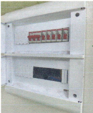
ESCOLA MUNICIPAL FRANCISCO TAVARES - DISJUNTOR 10 A
