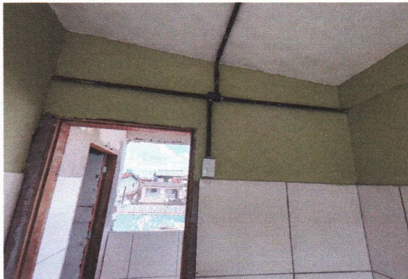
ESCOLA MUNICIPAL MARIA JOSÉ DE SOUZA - PONTO DE INTERRUPTOR (01 SEÇÃO) APARENTE COM ELETRODUTO DE PVC RÍGIDO
