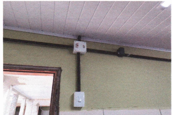
ESCOLA MUNICIPAL MARIA JOSÉ DE SOUZA - PONTO DE INTERRUPTOR (01 SEÇÃO) APARENTE COM ELETRODUTO DE PVC RÍGIDO
