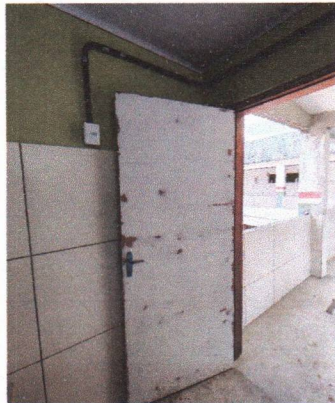
ESCOLA MUNICIPAL MARIA JOSÉ DE SOUZA - PONTO DE TOMADA 10A (01 SEÇÃO) APARENTE COM ELETRODUTO DE PVC RÍGIDO
