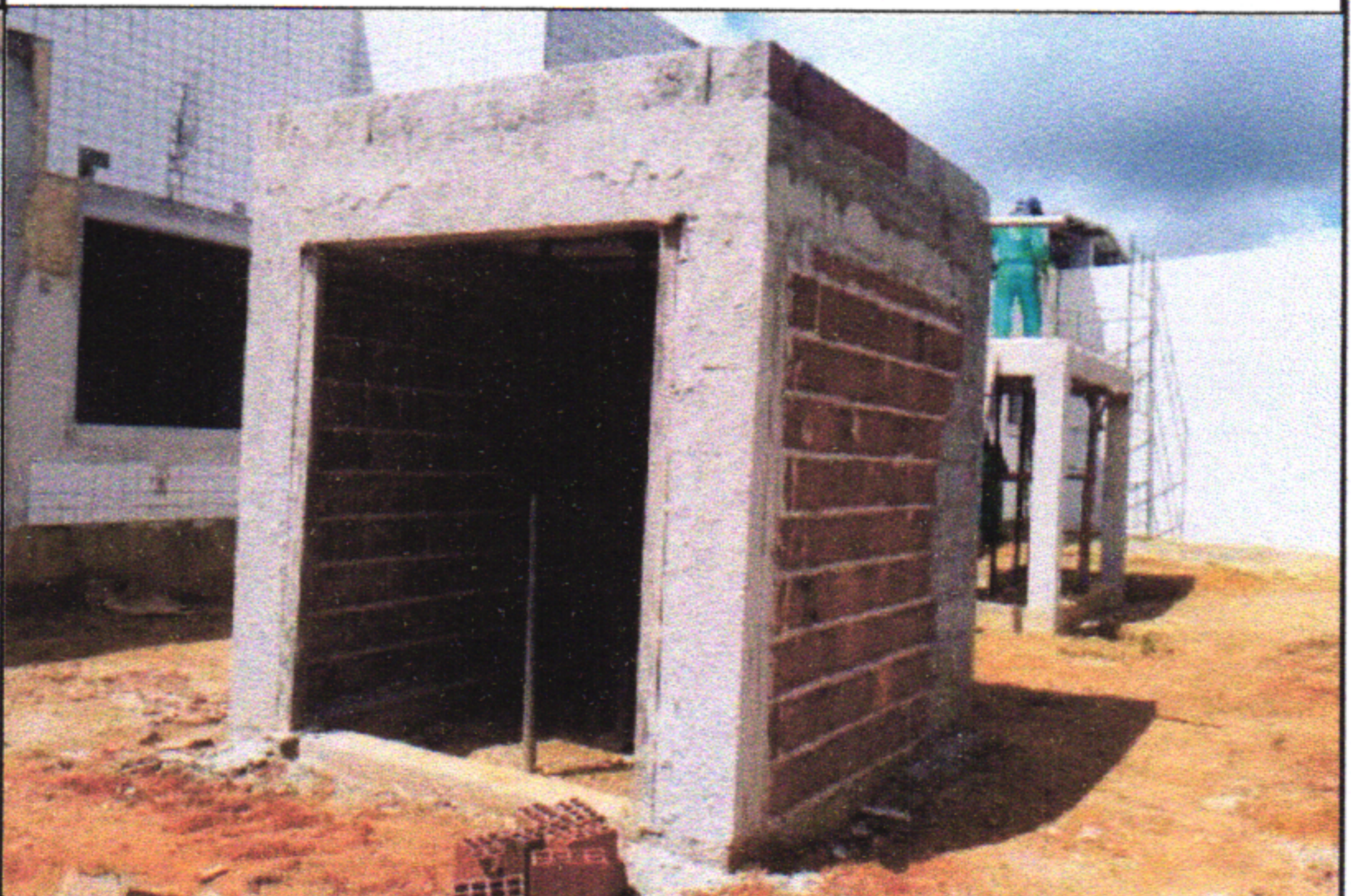
8.1 - ALVENARIA DE VEDAÇÃO DE BLOCOS CERÂMICOS FURADOS NA HORIZONTAL DE 9X19X19 CM (ESPESSURA 9 CM) E ARGAMASSA DE ASSENTAMENTO COM PREPARO EM BETONEIRA. AF_12/2021
