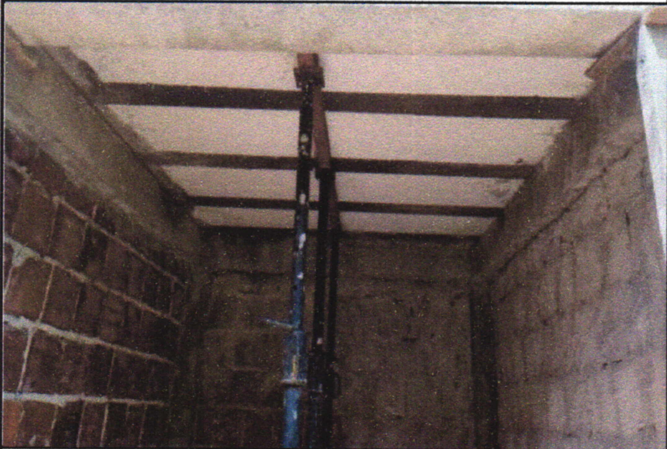
7.3 - LAJE PRÉ-MOLDADA UNIDIRECIONAL, BIAPOIADA, PARA PISO, ENCHIMENTO EM CERÂMICA, VIGOTA CONVENCIONAL, ALTURA TOTAL DA LAJE (ENCHIMENTO+CAPA) = (8+4). AF_11/2020_PA
