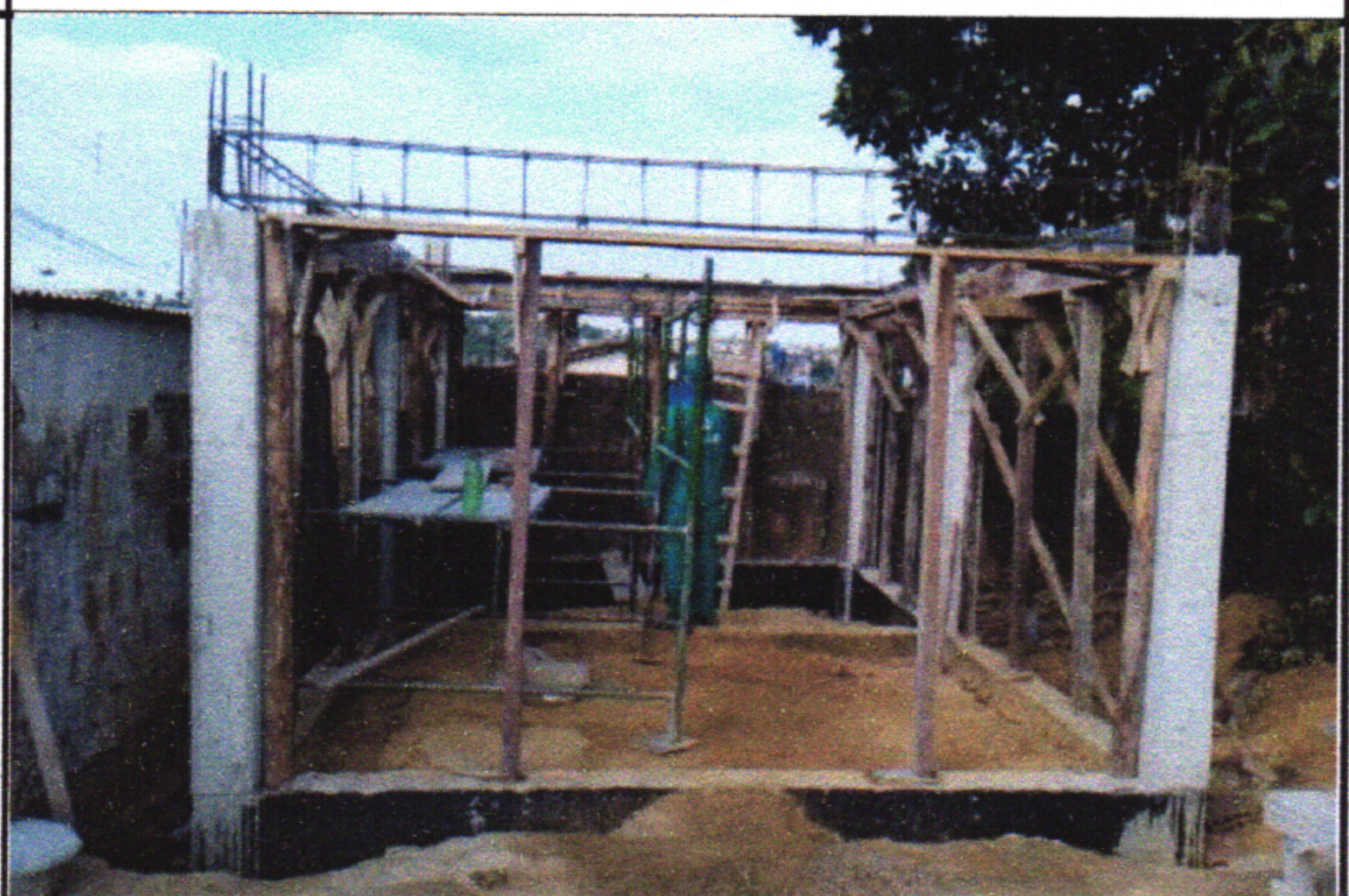
7.2 - MONTAGEM E DESMONTAGEM DE FÔRMA DE LAJE NERVURADA COM CUBETA E ASSOALHO, PÉ-DIREITO SIMPLES, EM CHAPA DE MADEIRA COMPENSADA RESINADA, 10 UTILIZAÇÕES. AF_09/2020
